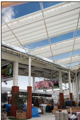
電動開閉式のテント屋根
